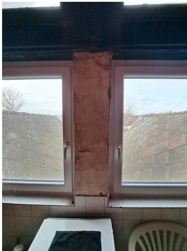
A két beépített műanyag ablak, közte a vakolat hibái
